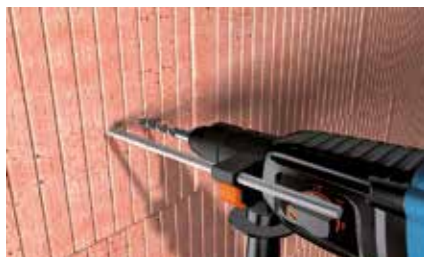
Fori su muratura
